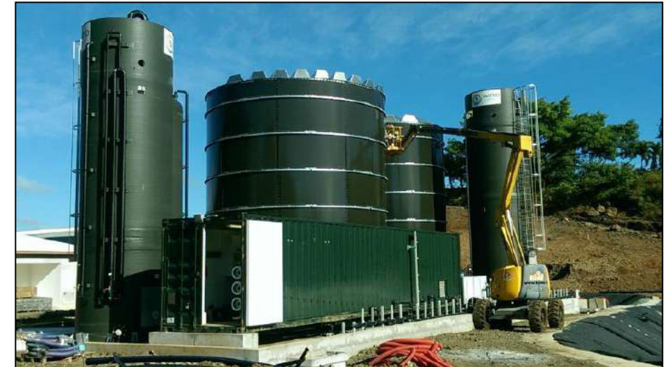
Unité de traitement des lixiviats
